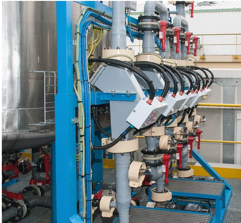
Electrodes industrielles installées sur une unité de traitement SOFHYS (secteur de la chimie)
