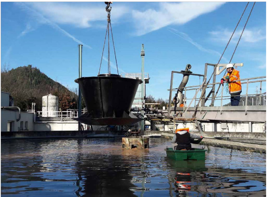
Dispositif permettant d'améliorer la décantation des matières en suspension Station d'épuration des Papeteries de Clairefontaine
