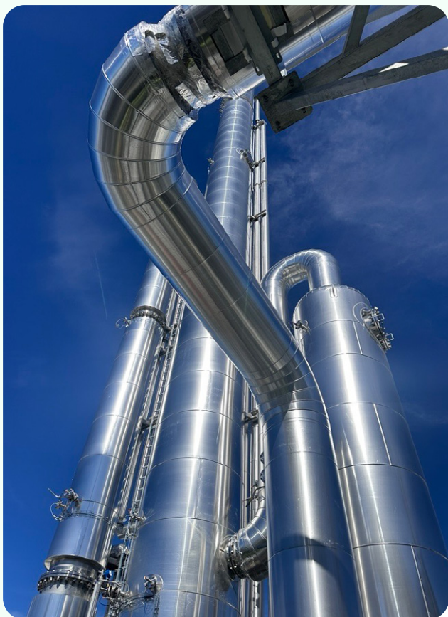
Fra karbonfangstanlegget på Østfold Energis avfallsforbrenningsanlegg i Rakkestad
