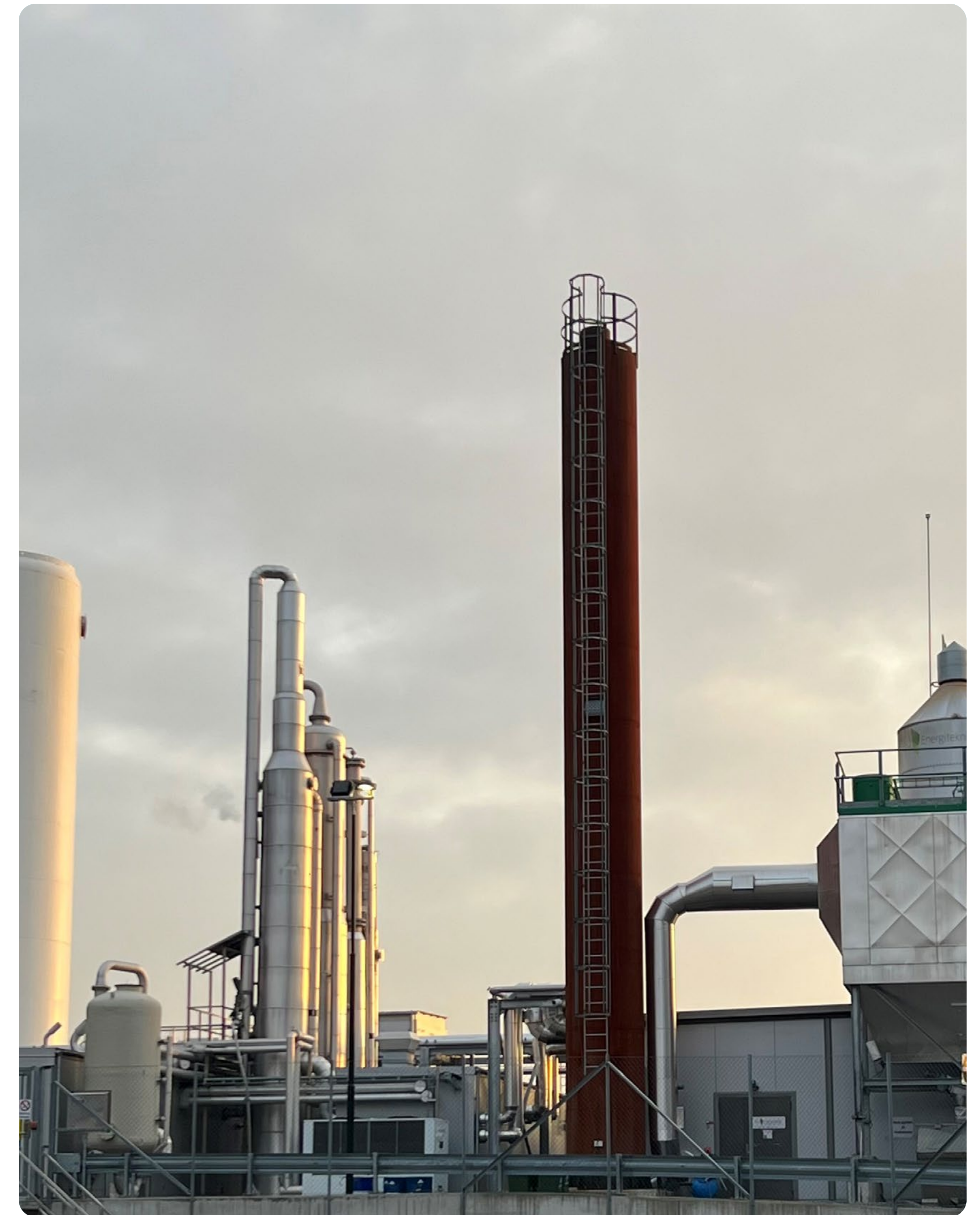
Oppgraderingsanlegget for biogass i Veas Næringspark.
