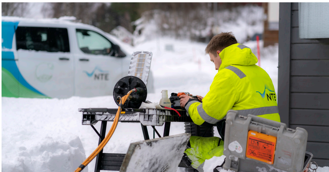
Jørgen Munkhaug er telekommunikasjonsmontør i NTE
