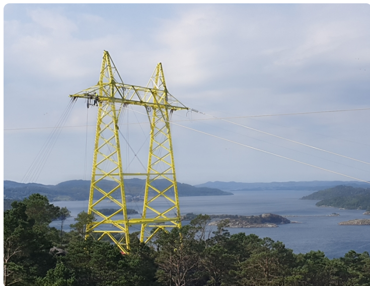
Lnett oppfyller alle krav for overjordiske høyspentlinjer som er kravet i miljømål 5, forebygging av forurensing.
