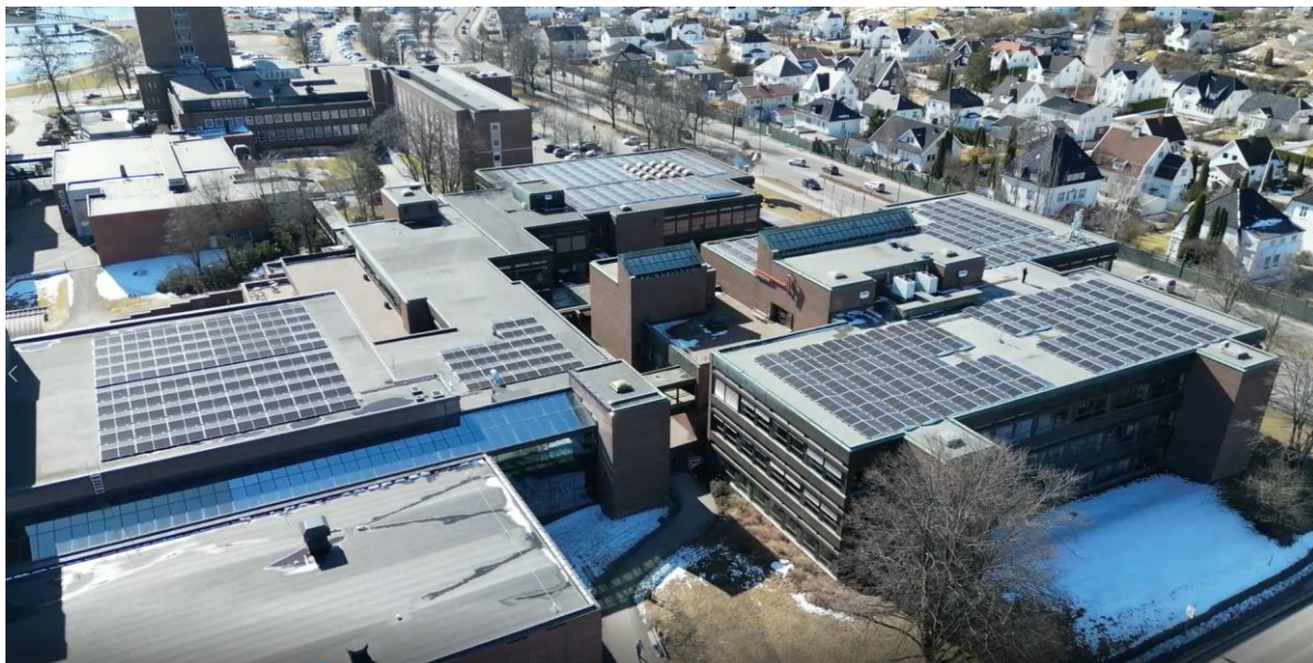
Solcelleanlegg på rådhuset i Sandefjord. Foto: Sandefjord kommune.
