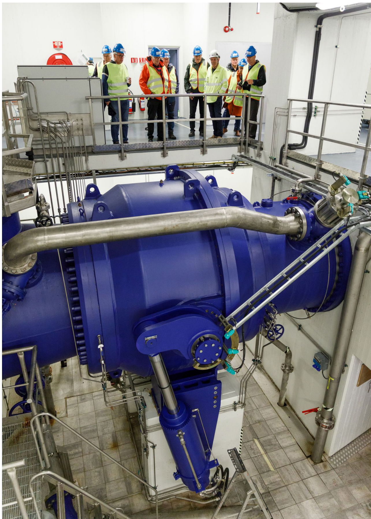
Åpen dag på Follafoss kraftverk
