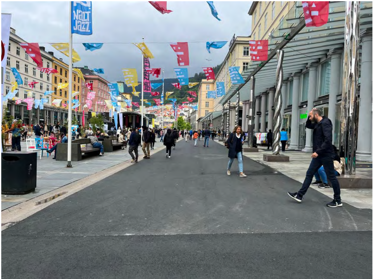
Deler av Torgallmenningen ble våren 2022 midlertidig asfaltert som følge av store skader på skiferdekket. Foto: Veronica Årseth Ljosheim
