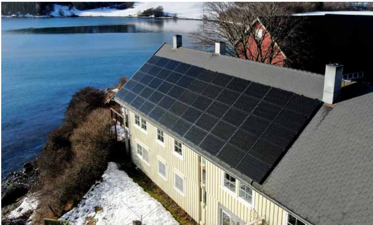
Solcelletak hos kunde Tor Ivar Barstad på Ytterøy
