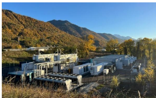
Le Cheylas, 10 MW bulk site (Isère)
