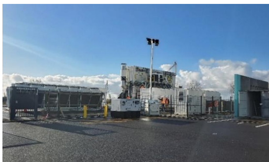
Croixrault, 5 MW bulk site (Hauts-de-France)
