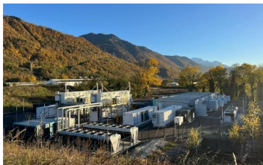
Le Cheylas, site bulk de 10 MW (Isère)
