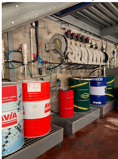
Nouveau système de distribution des huiles - site Iveco Bruges
