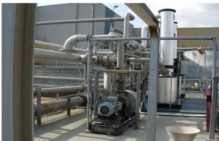
Lavage du Bio gaz
