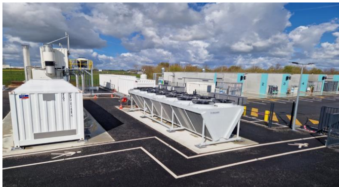
Site de 5 MW à Croixrault, Hauts-de-France, France
