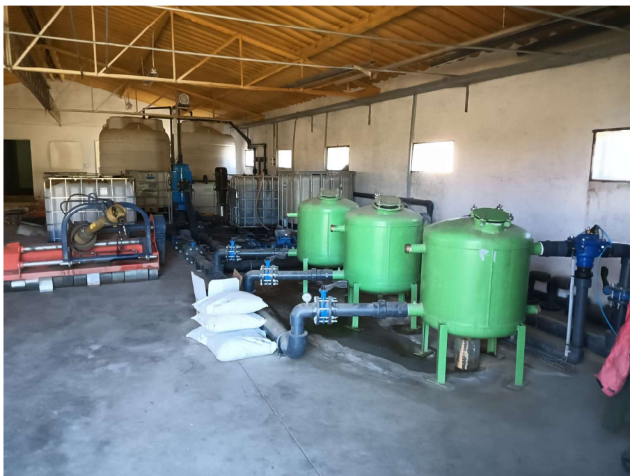
Interior armazém, filtros
