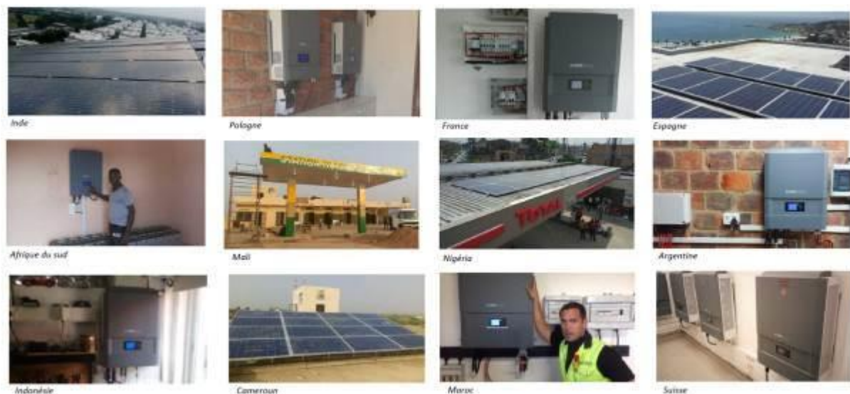
Figure 2 : Exemples d'installations IMEON ENERGY à travers le monde
