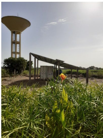
Sénégal : Conteneur OSMOSUN® avec générateur et château d'eau associé, ainsi que le filtre planté
